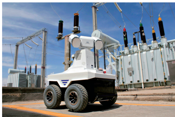
接触网智能巡检机器人正在作业。周悦翔 摄
