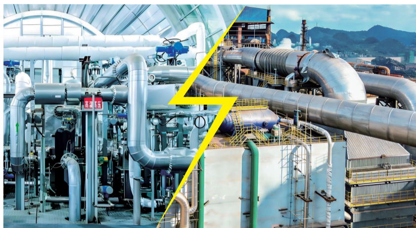
左图为超临界二氧化碳发电技术实验装置。右图为全球首个超临界二氧化碳余热发电技术“超碳一号”示范工程。 (图源:中核集团官网)
