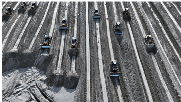
10月24日，第一师阿拉尔市塔里木河干流生态综合治理项目现场，数十台推土机依次排开平整土地。
