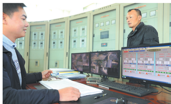
2024年12月28日，广州市从化区太平镇牛心岭水电站，工作人员在监测设备运行情况。
