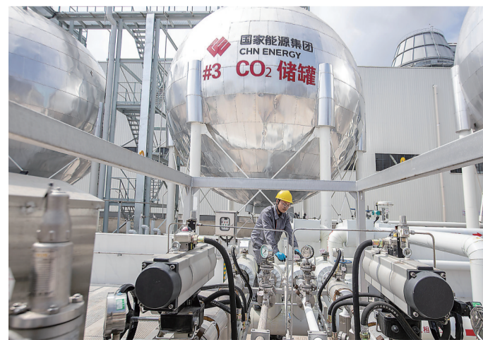
国家能源集团江苏泰州电厂二氧化碳捕集利用与封存项目完成满负荷试运行后正式投产。 新华社发 汤德宏 摄
