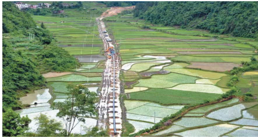
沼泽、水网地区管道施工现场。图为《走进石油》(第二版)中的《万里能源大动脉——油气储运》分册插图。
