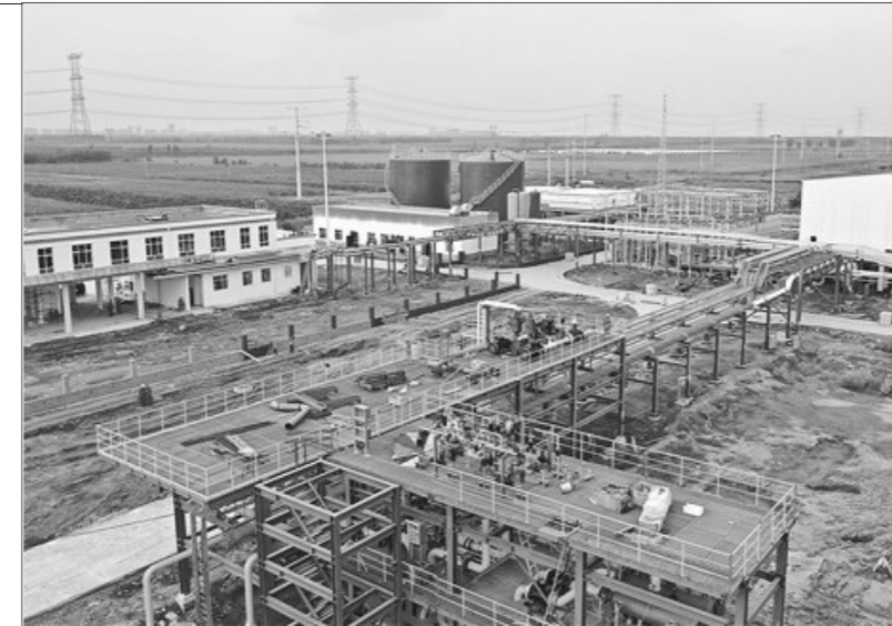
近日,华北油田文23储气库连接京二线的最后一道焊口完成焊接,标志着文23储气库天然气管道全线贯通。文23储气库建设是今年华北油田公司的重点工程。与同类施工相比,该项目技术难点多,施工工艺复杂,先后采用定向钻、顶管,以及开挖等施工工艺,为国内储气库大型管道施工提供了可借鉴的方案。 姜浩然 韩宗 摄
