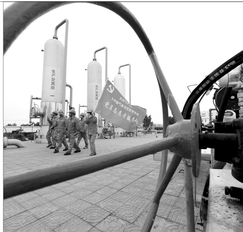
中国石化中原油田天然气产销厂党委，扎实开展“党旗在基层一线高高飘扬”系列活动，充分发挥党支部战斗堡垒和党员先锋模范作用。5月20日，天然气产销厂96储气库项目部党支部，组织党员集中开展注采流程检测和现场验漏工作。 赵奕松 范永光 摄
