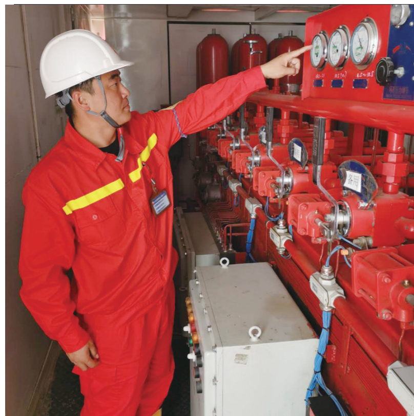
图为王立朝在检查远程控制房仪表压力
