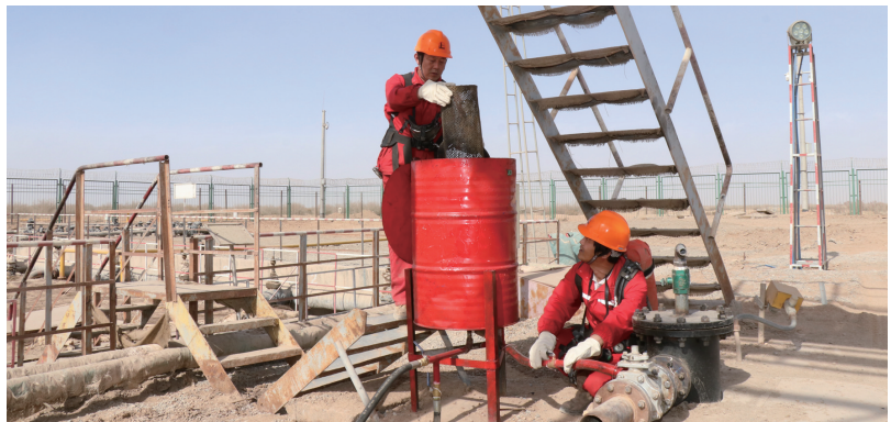
图为兄弟单位员工在现场学习使用清洗滤网机
