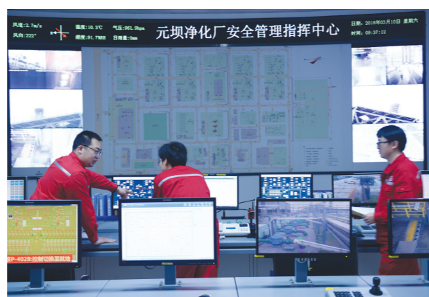
智能化监控系统做到安全生产无死角
