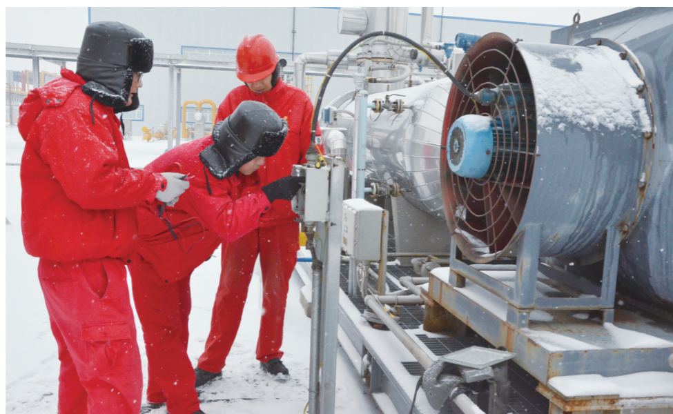
长庆采气二厂神木天然气处理厂员工正在检测压缩机稳定撬风机故障
