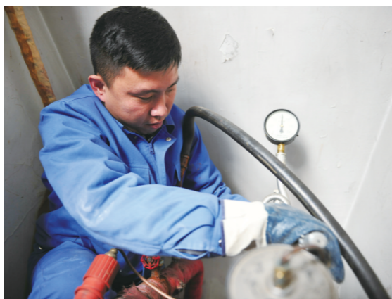
物管员维修管网间
