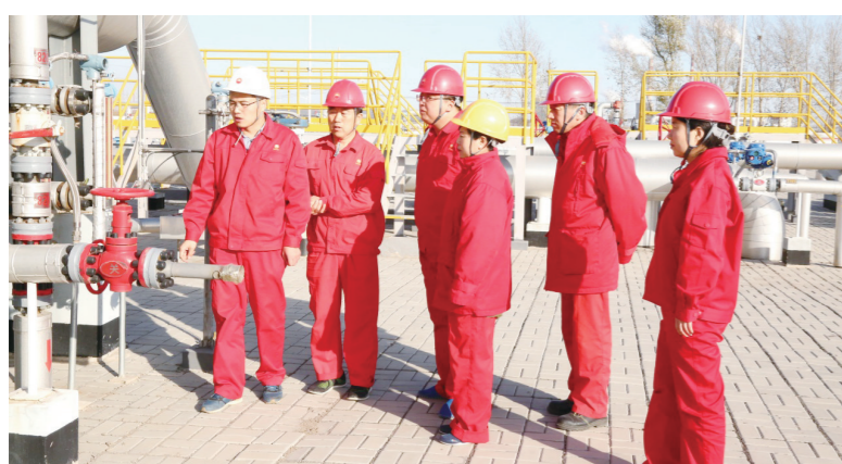
党员讲述输油气站设备冬季运行注意事项
