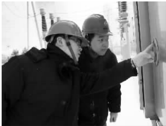
连日来的持续降雪,给大庆电力集团宏伟发电厂的室外输、供电线路和设备带来了安全隐患。该厂发电分厂电气运行员工针对特殊天气,加大巡视力度,加密巡视频次,做到提前发现隐患、及时处理缺陷,为用户用电和冬季供热提供持续稳定电源。图为这个厂员工正在检查220千伏开关SF6压力表。(王美琦)
