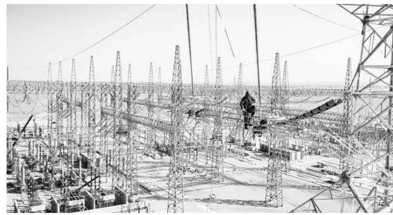
工人在新疆环塔里木盆地750千伏输电变电工程进行高空作业。 新华社记者 陈翔摄
