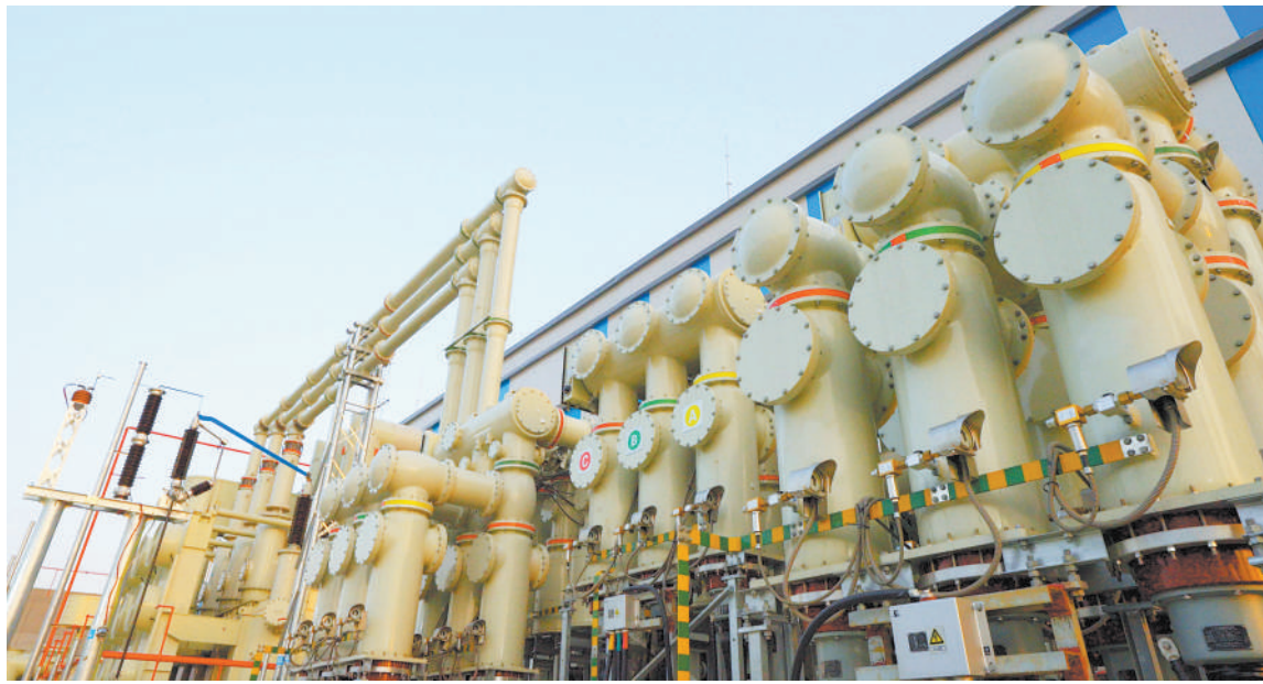
全球首座300MW压气储能示范工程“能储一号”。
