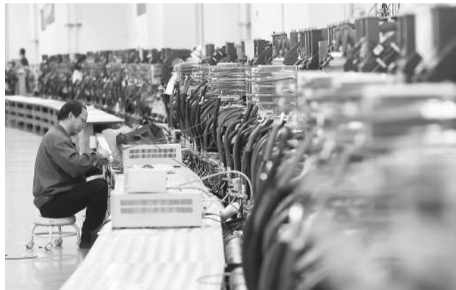
在怀柔科学城，工作人员正在高能同步辐射光源储存环中开展安装工作。 中新社记者 易海菲摄
