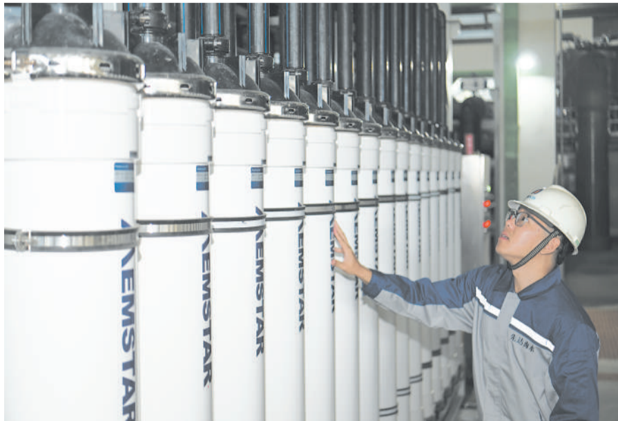
在位于天津南港工业区的先达(天津)海水资源开发有限公司海水淡化主装置生产车间,工作人员在巡检设备。 新华社记者 赵子硕摄
