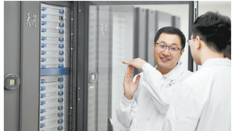
在国家超级计算天津中心“天河一号”机房内，研发团队在进行巡查。新华社记者 赵子硕摄
