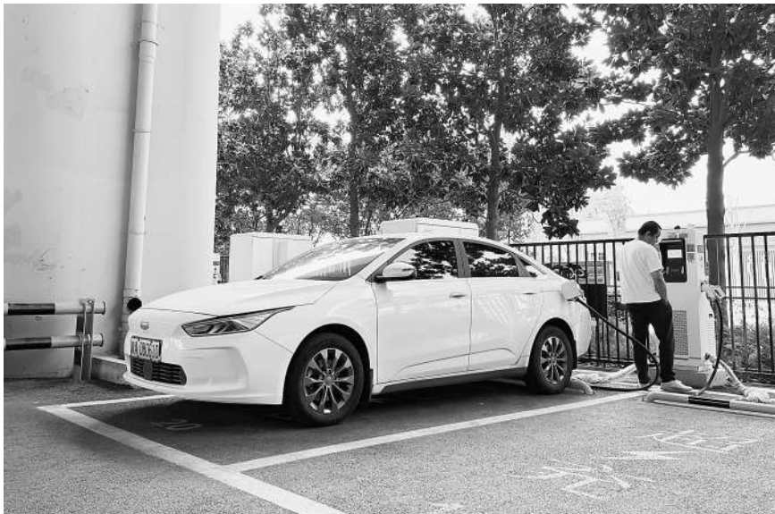
位于陕西省西安市朱宏路立交桥下的全液冷超级充电站内,新能源汽车正在充电。 本报记者 王禹涵摄
