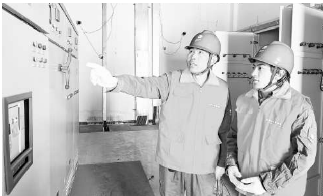
工作人员正在玛多县清洁取暖项目锅炉房的配电室内进行安全用电检查。 王翌萌摄
