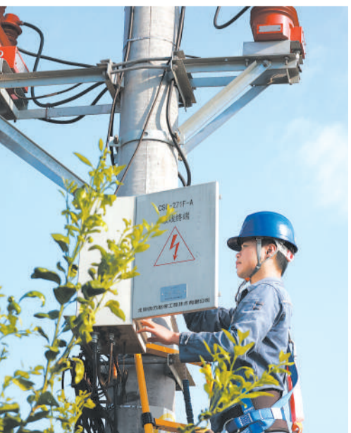
南方电网广西南宁宾阳供电局工作人员对古辣辖区内自动化开关进行巡检。 黄爱凌摄
