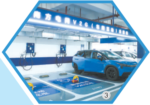
图③ 南方电网在深圳投运车网双向互动示范项目，电动汽车不仅可以充电，还可以“放电”，将车载电能送回电网，实现再利用。(黄志伟)
