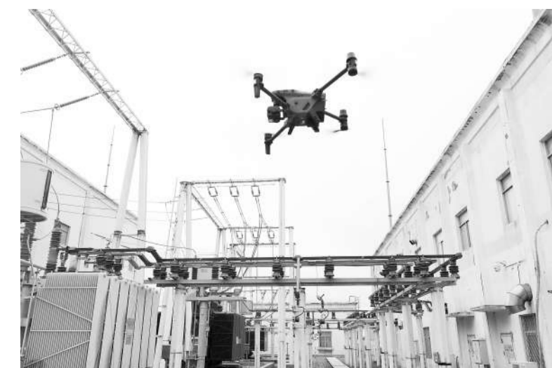
无人机在变电站附近开展自主巡检作业。 新华社记者 姜克红摄
