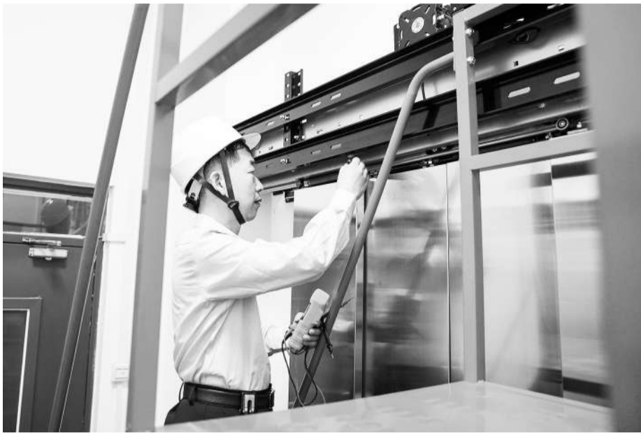
刘勇正在解决电梯故障。 天津机电职业技术学院供图
