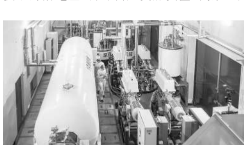
国网上海电力运维人员对超导电缆制冷系统开展巡视。
