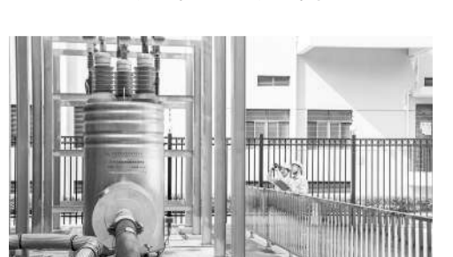
国网上海电力运维人员巡视超导电缆设备。
