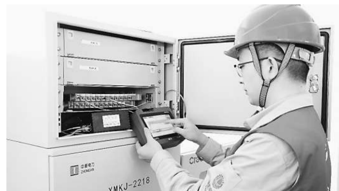
国网杭州供电公司工作人员正在测试新一代网络交换机应用后传输通道运行情况。鲁忆馨摄
