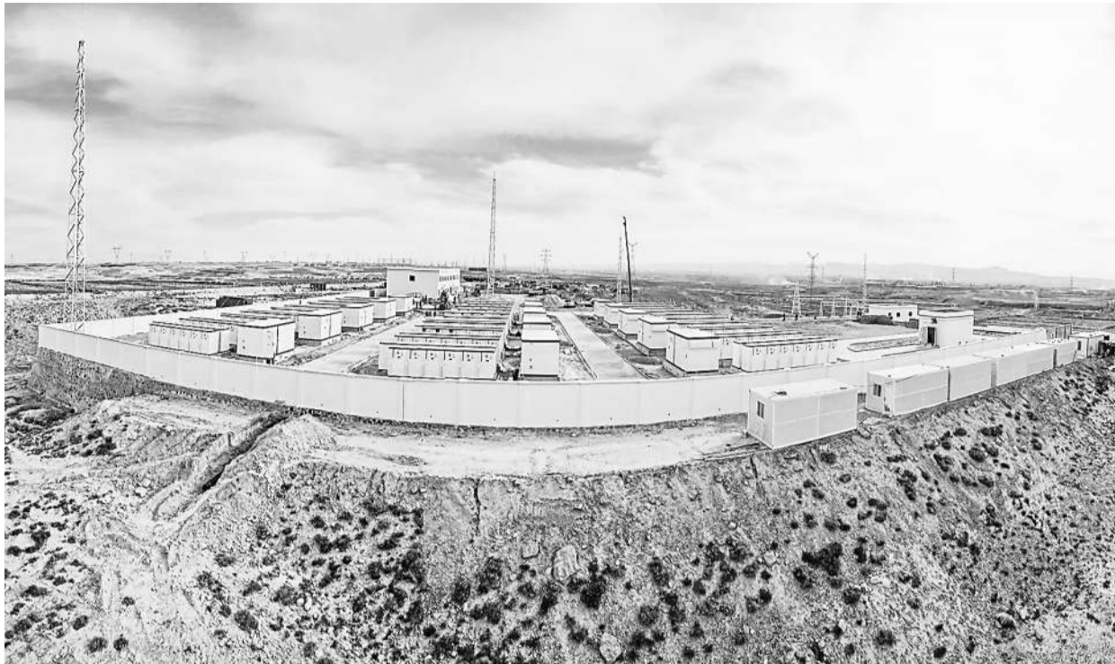
图为华严第一储能电站。
