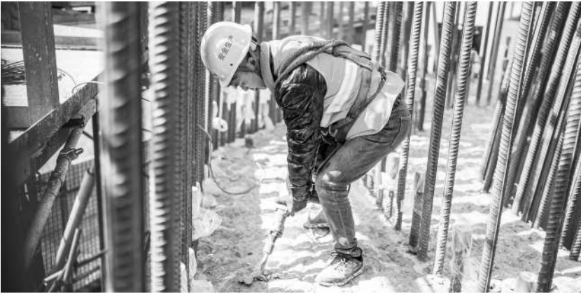
春节过后，贵州省全力推进重大项目复工复产，按下项目建设“加速键”。通过加强项目建设要素保障、补链延链强链等举措，贵州省确保2023年推进实施重大项目4000个以上，完成投资8000亿元，为新的一年高质量发展蓄势赋能。左图 工人在盘江新光燃煤发电项目现场施工（2月1日摄）。右图 工人在六安高速花江峡谷大桥主塔上施工（1月31日摄）。
