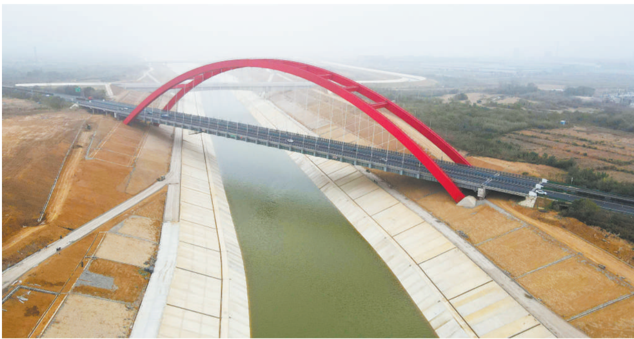
近日，由中铁十局三建公司承建的引江济淮工程（安徽段）菜菜线切岭段进入最后冲刺施工阶段，为引江济淮工程顺利通水通航提供了保障。引江济淮工程沟通长江、淮河两大水系，是我国跨流域、跨省重大战略性水资源配置和综合利用工程。图为中铁十局三建公司承建的引江济淮工程（安徽段）菜菜线切岭段（9月29日，无人机照片）。
