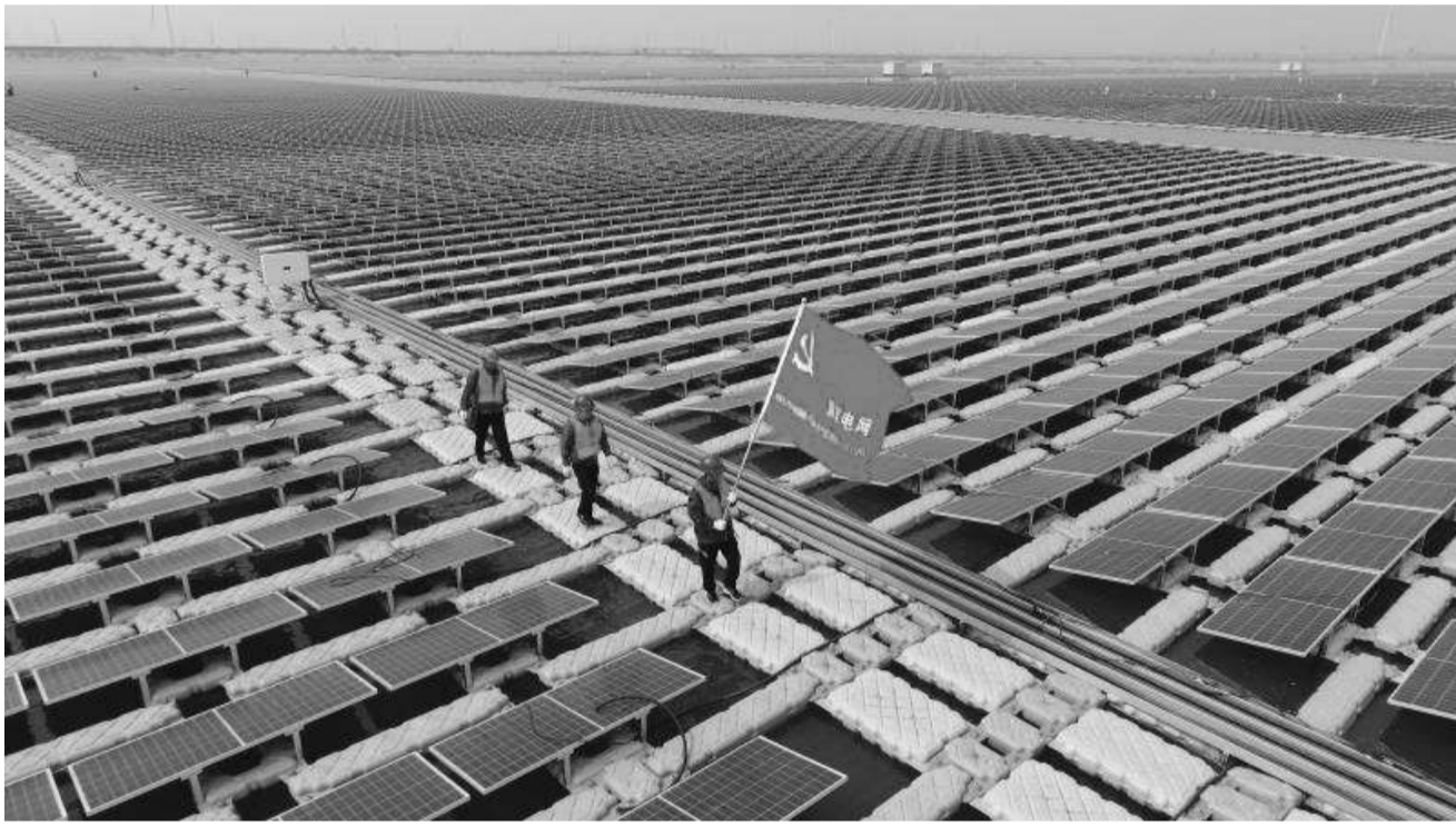
全球单体最大 水面漂浮式光伏电站并网发电
