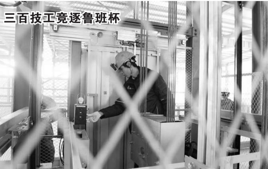
11月11日,2017年中国技能大赛“鲁班杯”全国首届电梯安装维修工职业技能竞赛决赛在山东省齐河县举行。来自全国18个省区市的379名选手晋级决赛,在理论知识和实际操作2个竞赛项目展开竞争。获得决赛综合成绩第一名的企业选手,将报请全国总工会优先推荐参加“全国五一劳动奖章”评选。图为参赛选手正在认真地比赛。 本报记者 周维海摄
