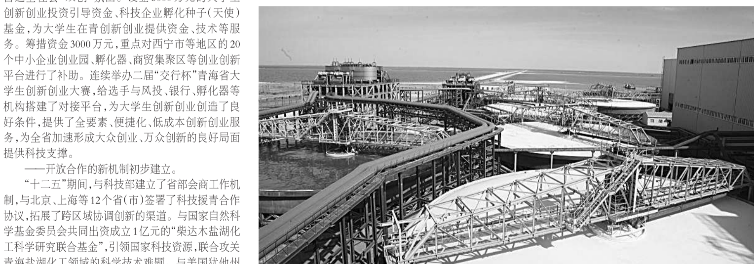
青海盐湖集团股份有限公司100万吨钾肥生产装置
