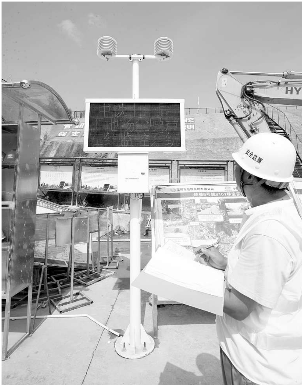
图为中国铁建11局集团在深圳地铁6号线大雁山隧道施工中,通过电子远程监控系统,实现了对掘进设备实时监控,强化现场安全环保过程监控。高仕红摄
