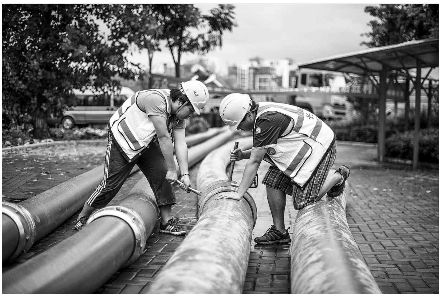
据气象部门预测,未来一周武汉将有2次暴雨,雨量在200至300毫米。武汉市各部门加紧湖泊排排水工作,腾出库容应对下一阶段的连续降雨。图为7月15日,武汉城投长江隧道“龙吸水”应急抢险突击队在南湖片区加紧抽排工作。
