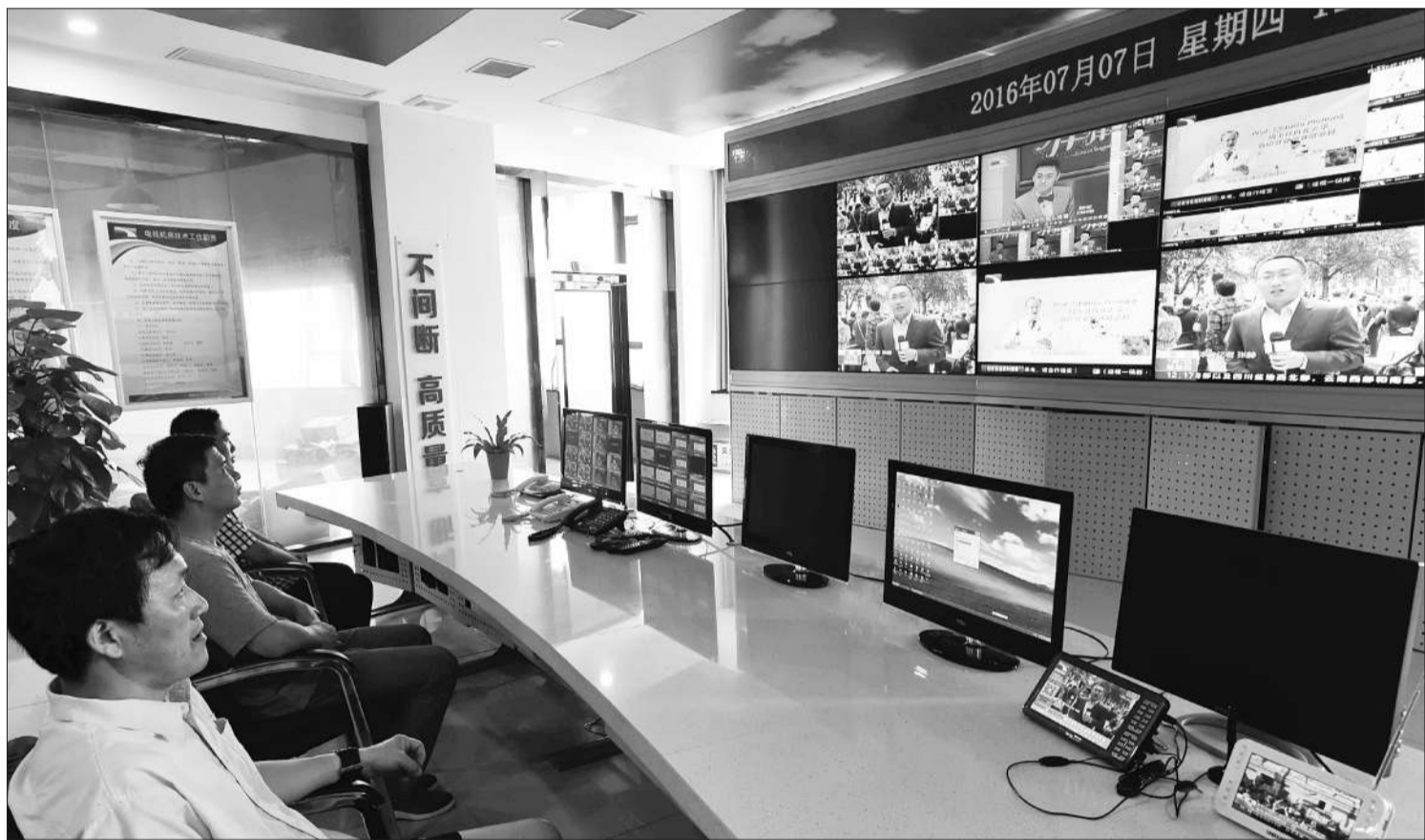
持续的暴雨雷电天气给广播电视信号传输带来一定影响,湖北省各地技术人员克服困难,坚守岗位,确保全省广电信号的稳定传输,方便广大群众接收最新信息。图为7月7日,位于武汉市龟山上的湖北省广电技术保障中心技术人员在监控电视信号传输情况。
