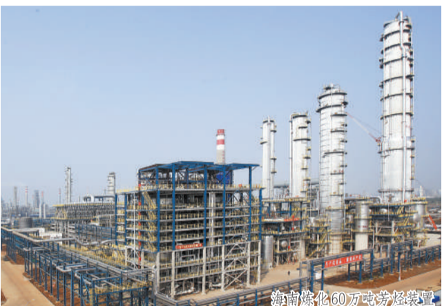
海南炼化60万吨/年对二甲苯装置
