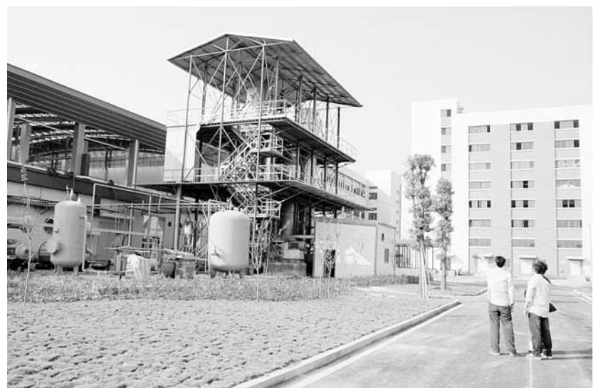
图为电镀废水“零排放”工程一角
