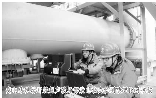
变电站现场开展超声波局部放电状态检测装置比对校验
