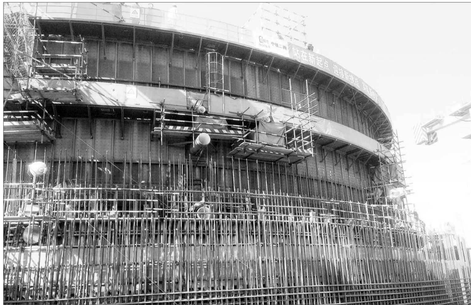
11月18日,福建福清市三山镇前薛村。我国具有自主知识产权的核电品牌“华龙一号”首堆——福清核电站5号机组,由中国核建二四公司承担的反应堆厂房土建工程,已施工至内壳钢衬里筒体第四层。
