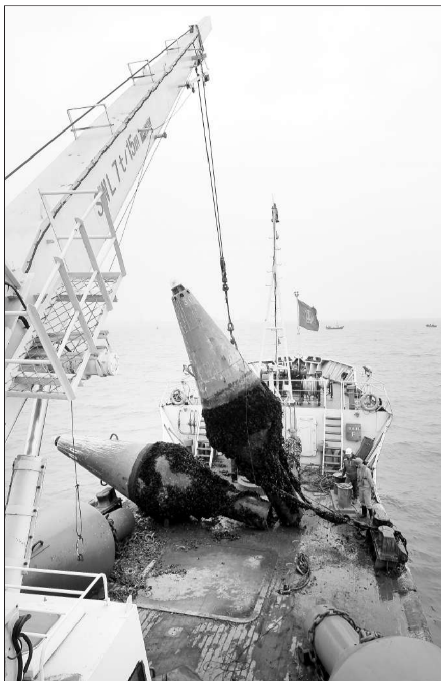
11月10日,航标工在海上更换航标。当日,北海航海保障中心秦皇岛航标处海巡1503航标船在秦皇岛港十万吨级航道抛设150号冰期灯浮标,标志着秦皇岛航标处辖区2015年冬季换标作业的全面启动。据了解,此项工作将持续到12月底,海巡1503航标船将对其所作业的秦皇岛港、山海关港、京唐港、葫芦岛港、锦州港的116座夏季航标进行更换,以保障渤海地区冬季航安安全。新华社记者 杨世尧摄
