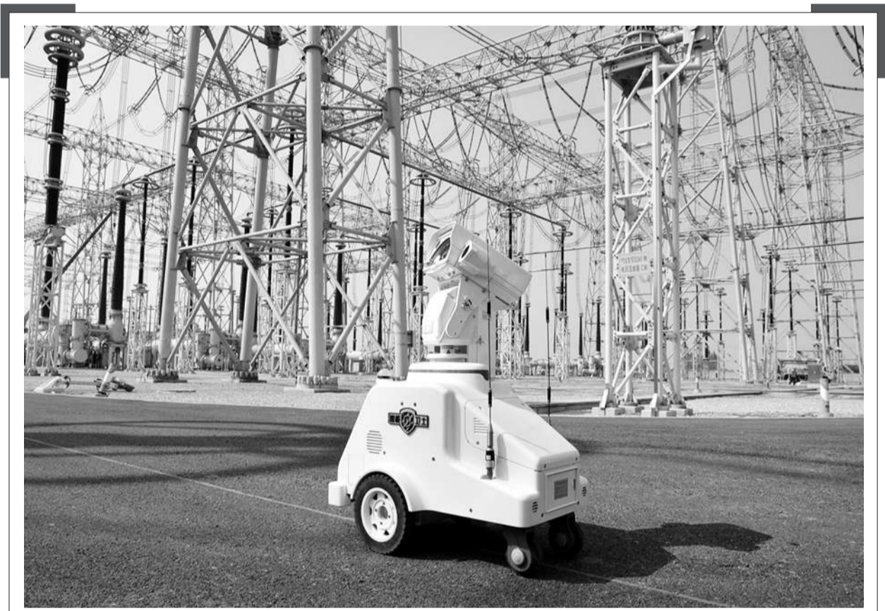
近日,一台智能机器人正在河南省方城县赵河镇境内的“1000千伏特高压变电站”进行巡检。该机器人搭载红外热成像仪、数据传输等设备,采集的温度、油位读数、开关状况、高压室环境等信息,实时回传给控制中心,如果数据异常,系统会发出报警信号,提醒维护人员采取相应对策。机器人系统的使用,实现了变电站全天候、全方位、全自主智能巡检和监控,大幅降低了人工劳动强度和运维成本,实现了变电站巡检的“无人化”。
