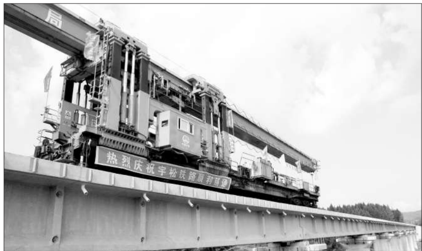
8月12日,在吉林省松江河镇铺架现场,来自中铁四局八分公司的员工们庆祝吉松铁路全线贯通接轨。新建靖宇至松江河铁路工程(简称吉松铁路)经过6年多建设推进,终于取得阶段性胜利。 郑红梅摄
