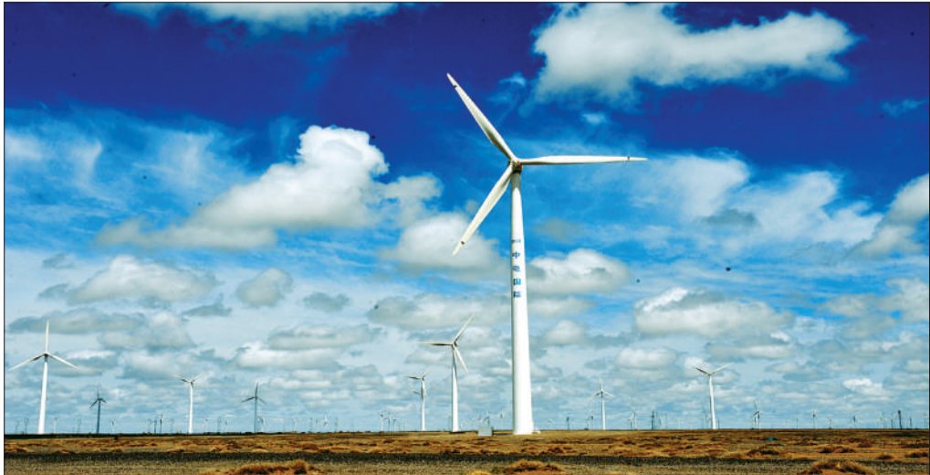
近日,记者从甘肃省电力公司了解到,甘肃省风电装机已经突破千万千瓦,截至5月底已达到1052.7万千瓦,在国内仅次于内蒙古,居第二位。图为甘肃省酒泉风电基地瓜州北大桥风电场。新华社记者 连振祥摄
