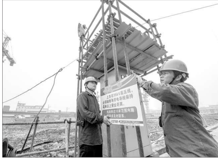
从6月上旬开始,浙江省杭州市萧山区开展为期12天的输电安全联合整治行动,由萧山区供电公司、住建局安监站、公安等多部门联合发起,全面梳理高压输电线路周边的建设工地,对前期梳理发现的共18个施工隐患现场进行集中性整治,涉及110千伏线路13条,35千伏线路5条,力争全面消除供电线路周边因施工带来的安全隐患。图为6月18日,电力工作人员在一处工地悬挂警示标志。
