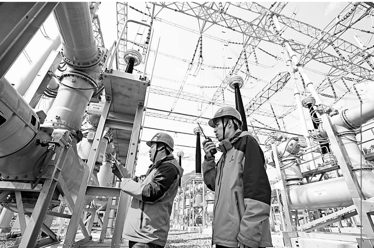
浙江省首座500千伏全数字化智能变电站——吴宁输电工程在浙江省东阳市正式投运,工程本期新安装100万千瓦安主变2组,远景将安装100万千瓦安主变4组。500千伏吴宁输电工程是国家重点能源建设项目,也是国家电网第二批智能变电站试点工程。工程投运后将为地方经济持续快速发展提供充足的电力保障,有效提升区域供电能力和电能质量。图为浙江省电力公司员工在500千伏吴宁变电站巡视电力设备。 新华社发
