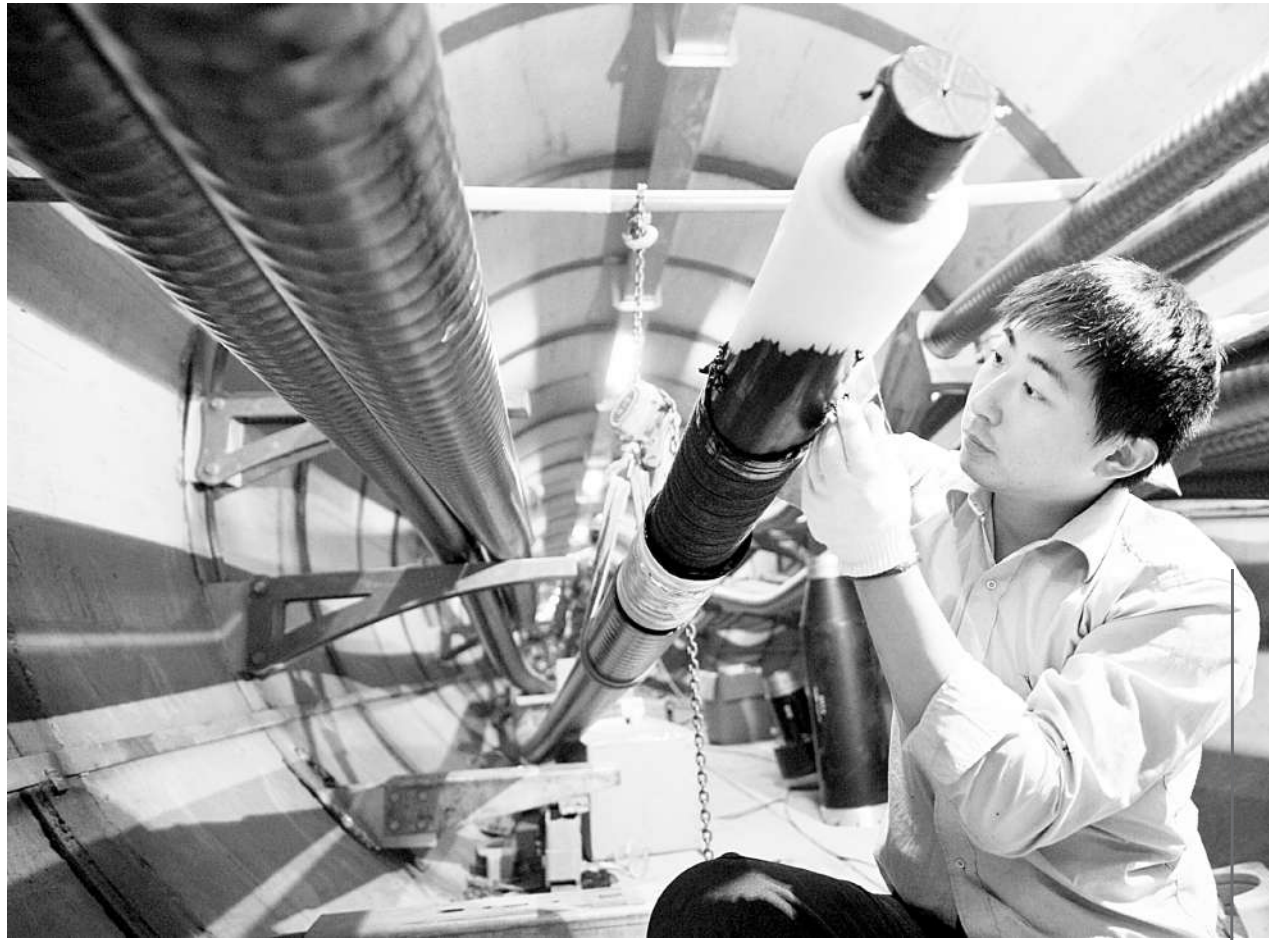
江苏无锡加快电网建设加强冬季供电,图为11月4日在江苏无锡220千伏夔澜输变电工程工地上,电力职工在安装制作电缆接头。
