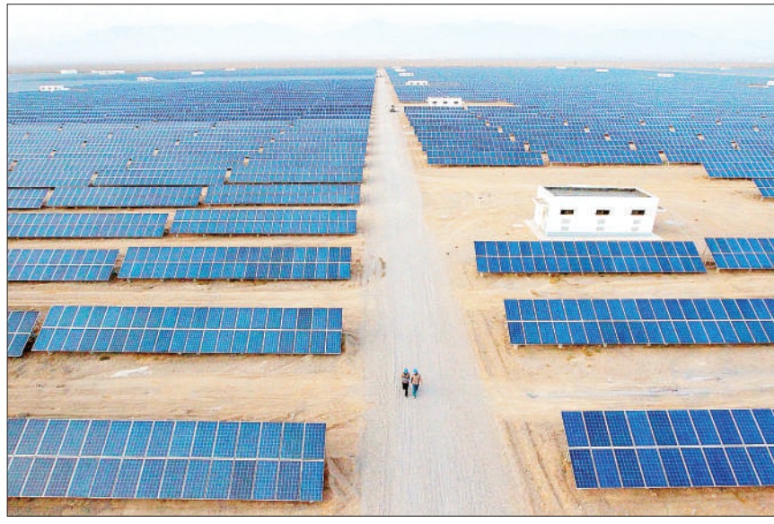
新疆哈密风电、光电资源丰富,截至目前,新疆哈密获得核准风电项目55个,总规模426.9万千瓦,现已有22个风电项目并网发电,容量达126.9万千瓦;获得核准光伏项目31个,总规模66万千瓦,现已有11个光伏电站并网发电,容量达21.5万千瓦。图为技术人员从新疆哈密石城子光伏园区的太阳能电池板旁走过。新华社(蔡增乐摄)
