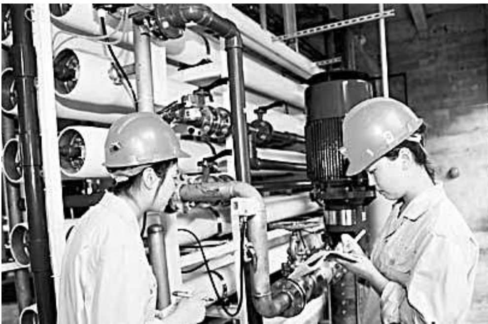
甘肃宝徽集团工作人员正在查看污水处理系统运行情况。该集团大力发展循环经济,实施了总投资4491.45万元的重金属污水治理项目和总投资5956万元的酸漫渣回收银项目。
