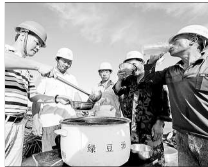
连日来,福建平潭出现持续高温天气。平潭海峡大桥的工地错开高温时段,每天上午10时至下午3时停止所有户外施工作业。
